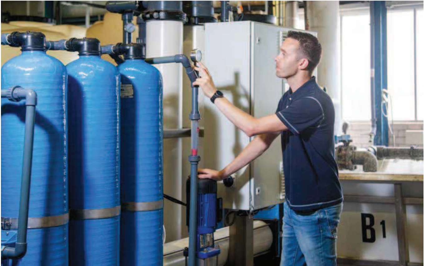
Teler Stephan van der Lans is de eerste die een nieuwe zuiveringsinstallatie heeft laten plaatsen. "Ik verwacht dat het rendement van de teelt hiermee omhoog gaat."
